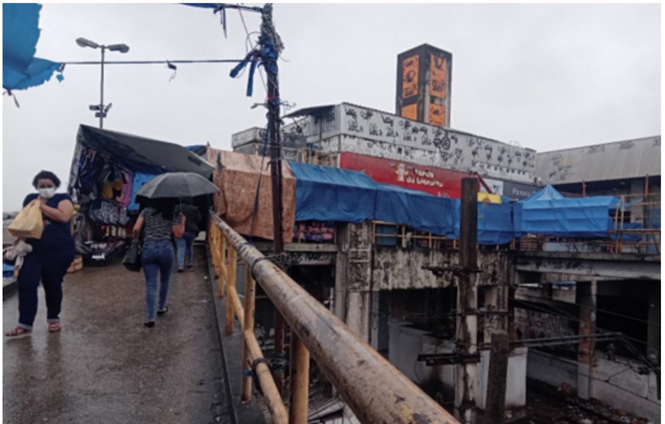
Figura 15: Foto da passarela de acesso à estação de metrô da Pavuna em que se observa bancada de venda ambulante se utilizando do guarda-corpo metálico como suporte. As barras metálicas em que se apoiam as lonas são pré-fixadas nas barras dos guarda-corpos da rampa e passarela. Fonte: autora (2023)
